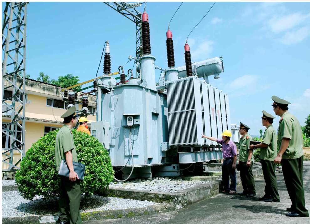
Lực lượng An ninh kinh tế tiến hành kiểm tra hệ thống trạm biến áp, đường dây tải điện tại Chi nhánh lưới điện cao thế Điện Biên
